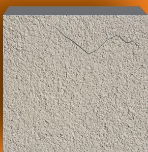
Support irrégulier (faïencé et réparé)
